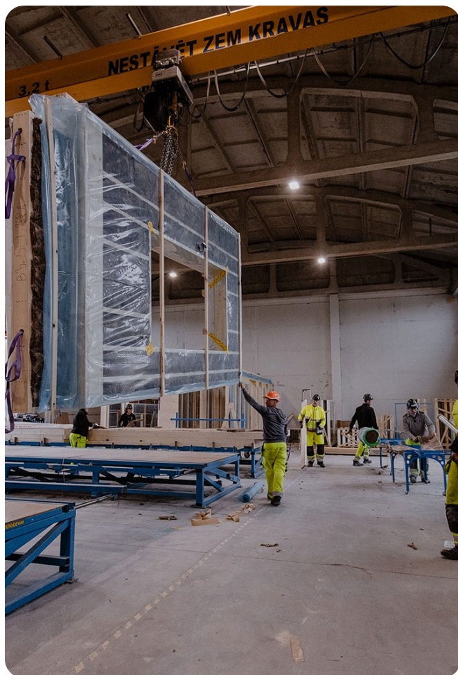
Painel de parede na fábrica, Birzgale
