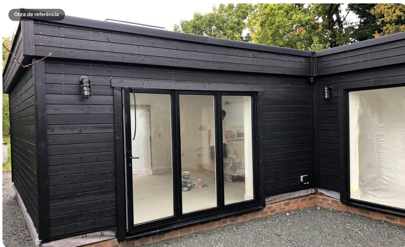
Reino Unido — obra de referência da fábrica
